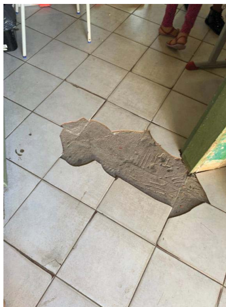
Piso cerâmico existente que deverá ser substituído
