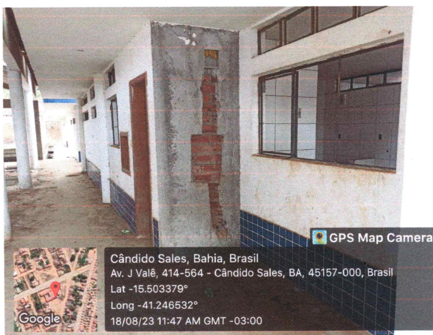
Bloco de serviço, sem o quadro de energia, as fiações elétricas, sem vidros laminados nas
