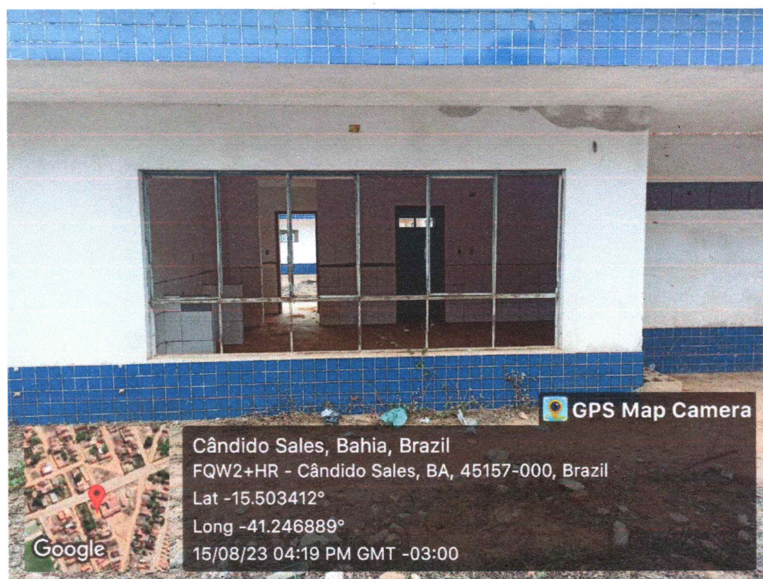
Sala Creche II – Problemas de infiltração devido o telhado avariado
