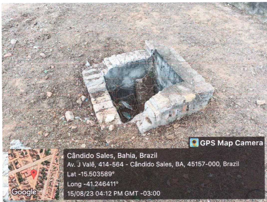
Caixas de inspeção danificadas.
