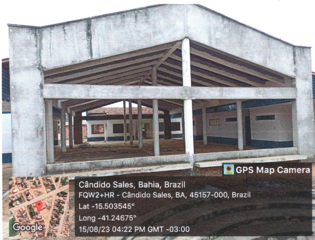
Pórtico do fundo do refeitório sem o revestimento cerâmico previsto em projeto.
